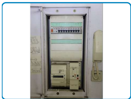
COMPTEUR, AGCP et TRP (dans R+2 Dégagement)
