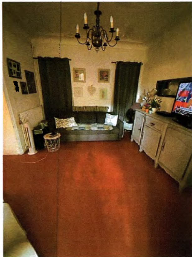
Les murs sont recouverts d'un crépi dégradé.
